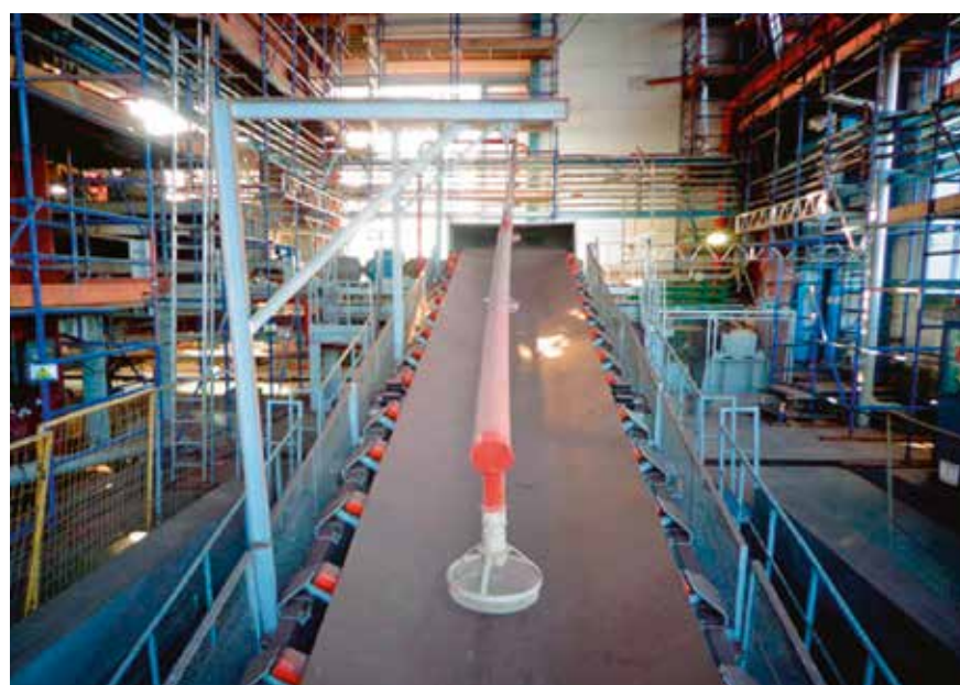
Здание УПТ, отм. –1,000, конвейерное оборудование (1/2E)
