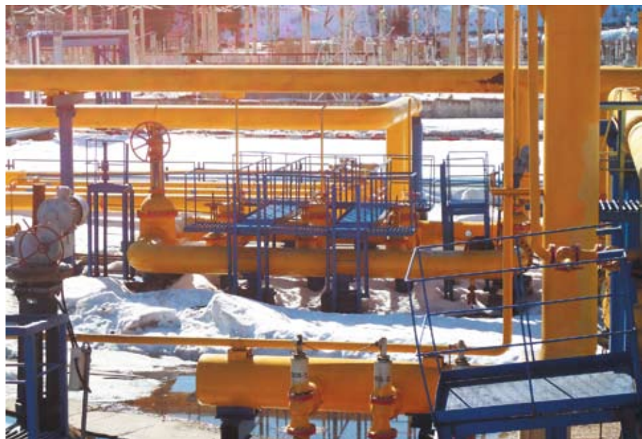
Газораспределительный пункт (ГРП)
