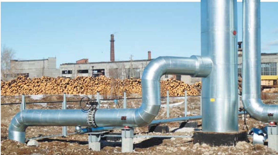
Сепаратор, очищающий газ от примесей перед подачей на станцию
