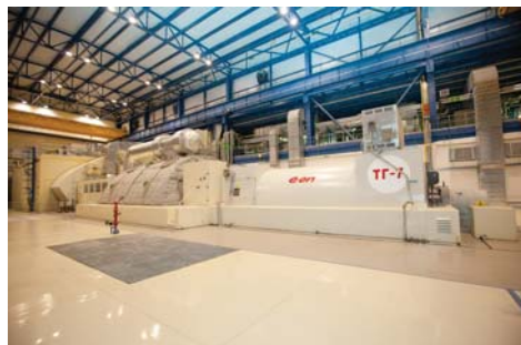
Энергоблок №7 Шатурской ГРЭС отвечает самым высоким требованиям к эффективности и экологичности производства электроэнергии
