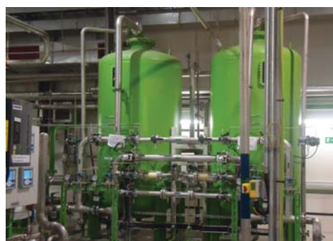
Фильтры механической очистки пропускают по 20 кубометров воды в час
